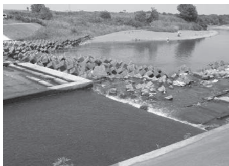
菅間の堰の上流側。永年の洗堀によって右岸側にもエプロンの下端に70cm程の落差ができています。
