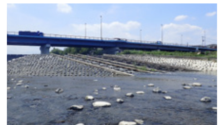
豊水橋床固め工の魚道(2016年完成)
