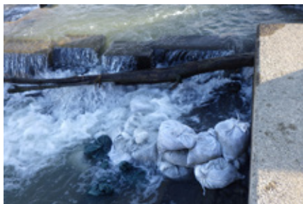
土砂吐け下のプールの落差解消のため置いた土嚢は一部流された(16日)
