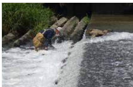
中の砂礫が流された土嚢袋を回収した
