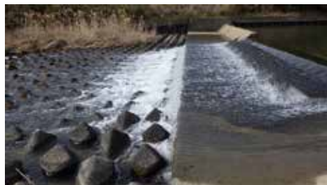
左岸側から見た長楽堰。堰堤下に約50cmの落差があり、魚の遡上を困難にしている
