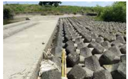
増水で土嚢が流失し落差が再発生した堰堤
