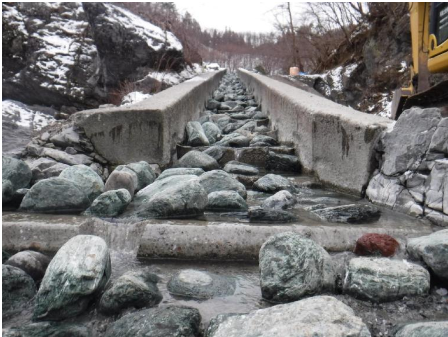
1/5勾配の プール式魚道
